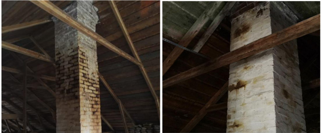
Kuvat 45 - 46. Valumajälkiä piipuissa.
