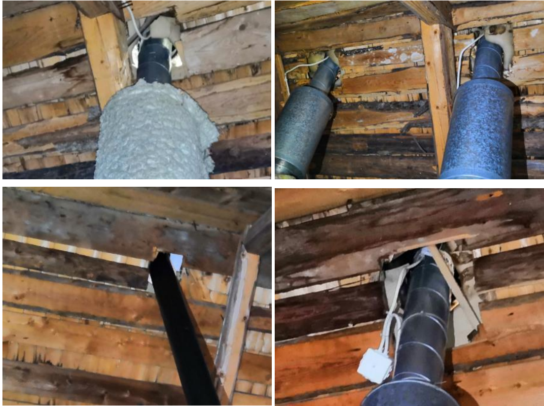
Kuvat 41 ja 42. Sekä uuden että vanhan puolen läpiviennit olivat epätiivittä. Kovalla tuulella niistä saattaa kulkeutua vettä sisälle.
