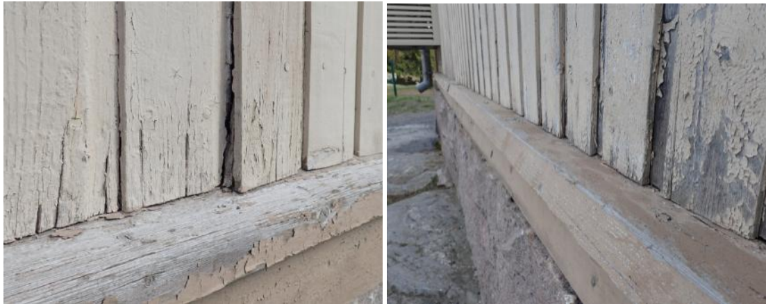
Kuvat 29 ja 30. Ulkoverhous on paikoin heikkokuntoinen.
