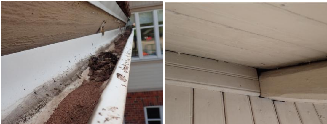
Kuvat 47 ja 48. Osalla räystäkouruista oli runsaasti likaa. Alaräystäät ovat ummessa estäen tuuletuksen.
