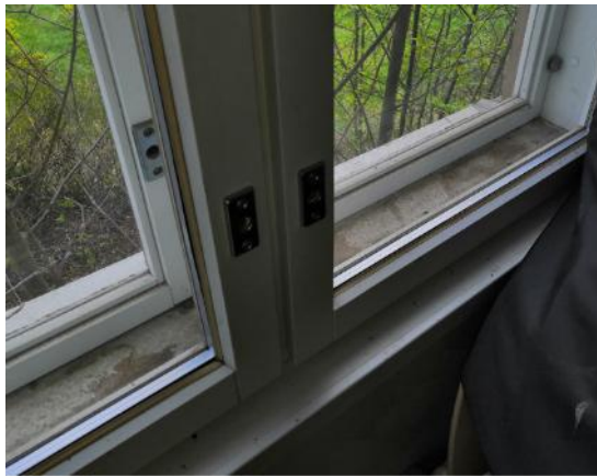
Kuvat 25 ja 26. Ikkunoiden välissä todettiin paikoin runsaasti likaa.
