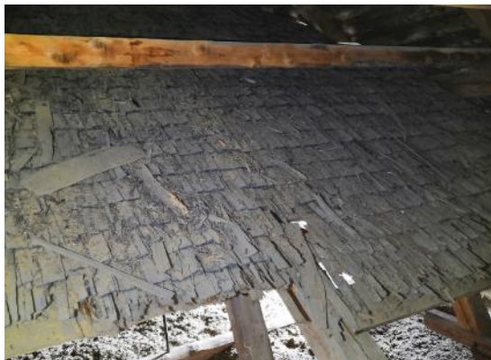
Kuva 40. Vanhaa, erittäin pitkälle lahonneutta yläpohjan pärekatteista vesikattoa vanhan osan yläpohjassa. Kuva otettu uuden ja vanhan rakennusosan liittymästä.
