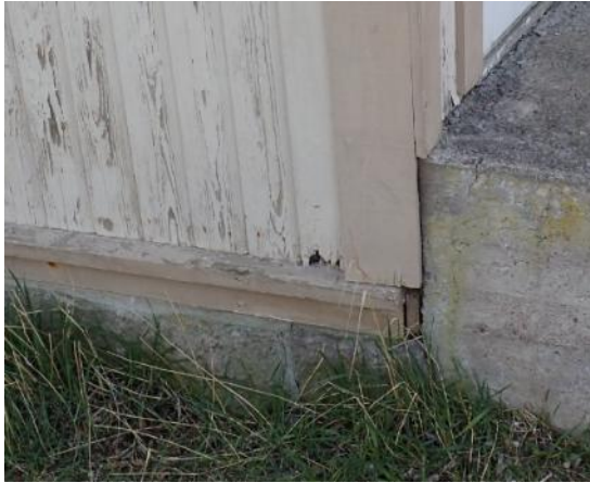
Kuvat 27 ja 28. Betoniluiska porstuan 116 sisäänkäyntiin on valettu kiinni puuosiin.
