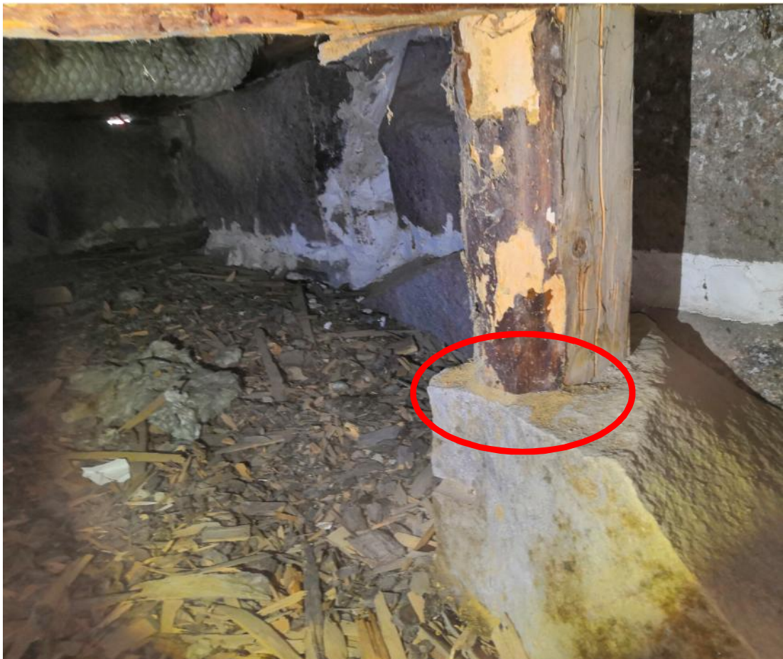
Kuva 11. Kuva ryömintätilasta läheltä porstuaa 116. Alapohjan kannuspilarihirressä hyönteisvaurioita. Hyönteisten jätöksiä (puupuru) ympyröitynä kuvaan. Maapohja on puulastun ja muun rakennusjätteen peitossa.
