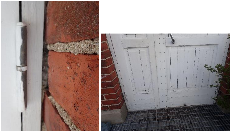
Kuvat 33 ja 34. Ikkunoiden ja tiiliseinien liittymät ovat epätiivittä. Lounaispäädyn ulko-ovi on haristunut.
