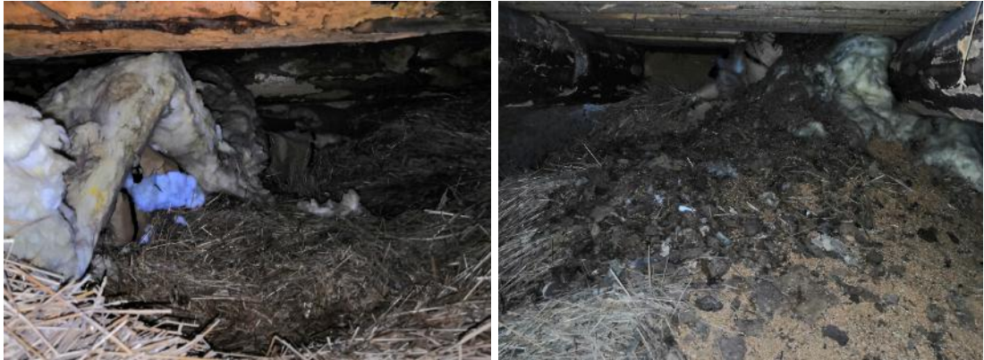
Kuvat 12 ja 13. Rakennuksen itäosassa ryömintätilaa maanpinta nousee kiinni alapohjan puuosiin asti, aina alapohjan kannatinhirsien väliin asti.
