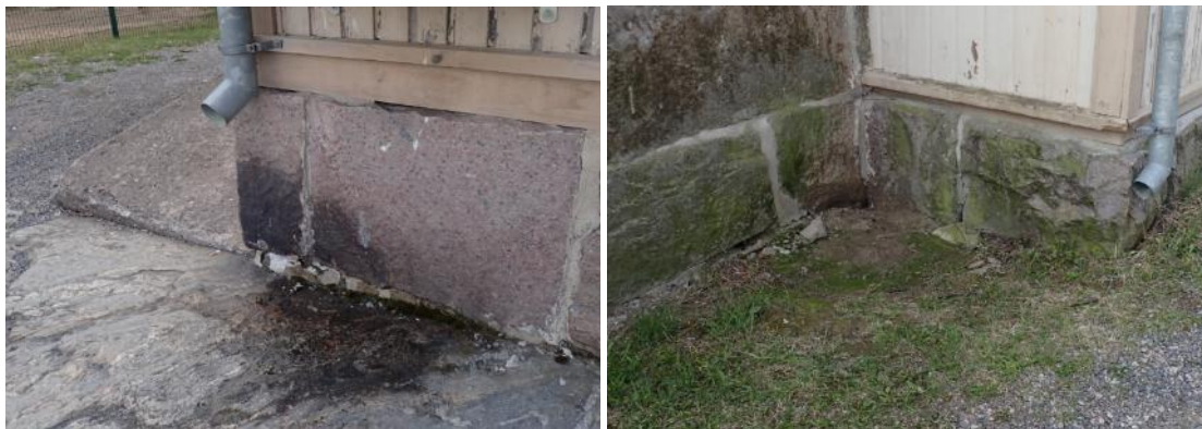
Kuvat 2 ja 3. Maanpinta viettää paikoin rakennuksen suuntaan, mahdollistaen pintavesien virtaamisen rakennuksen alle.
