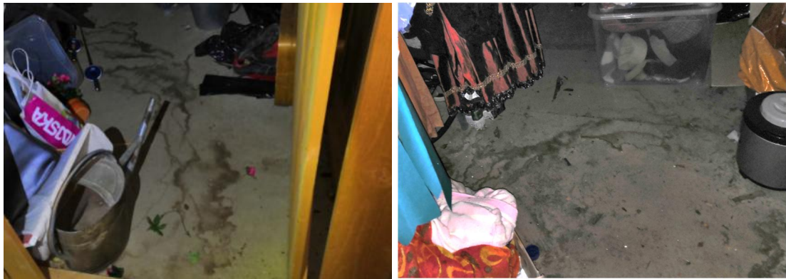
Kuvat 38 ja 39. Uuden puolen ullakon varastotiloissa oli runsaasti kastumisjälkiä. Levylattiassa kastumisjäljet erottuvat, toisin kuin vanhan puolen puhallusvillassa.
