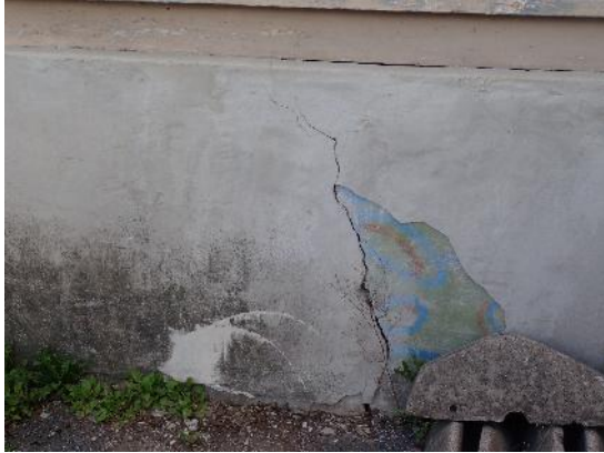
Kuva 6. Eteisen ja tuulikaapin sokkelissa on suuria halkeamia.
