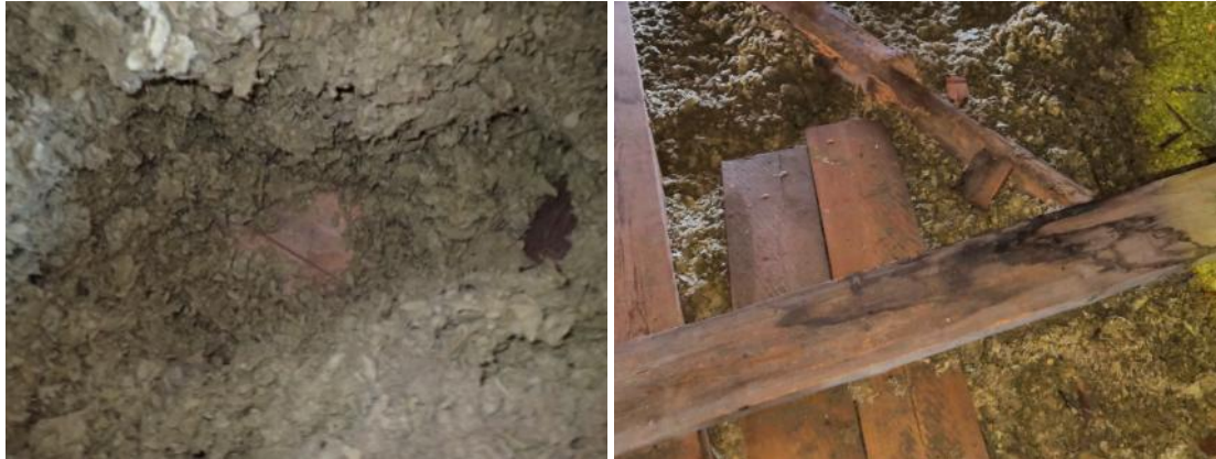
Kuvat 36 ja 37. Vanhan puolen yläpohjassa on yläpohjarakenteen päälle puhallettu lisäeristeeksi kerros puhallusvillaa. Kulkusilloissa oli paikallisia vesivuotojälkiä.
