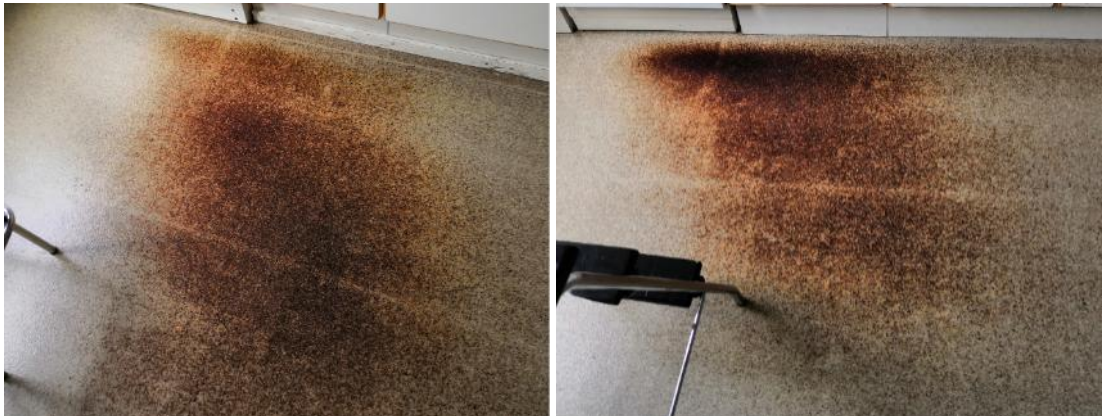
Kuvat 17 ja 18. Keittiön 109 lattian muovimattopäällysteen tummentumat.
