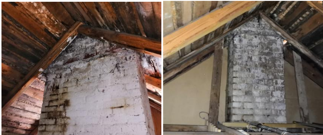
Kuvat 43 ja 44. Kaikissa neljässä tiilimuuratussa piipussa oli runsaasti valumajälkiä.
