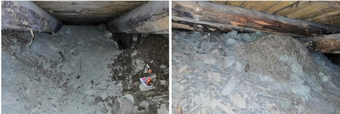
Kuvat 14 ja 15. Itäosassa ryömintätilaa maanpinta nousee kiinni alapohjan puuosiin asti, aina alapohjan kannatinhirsien, nk. niskojen väliin.
