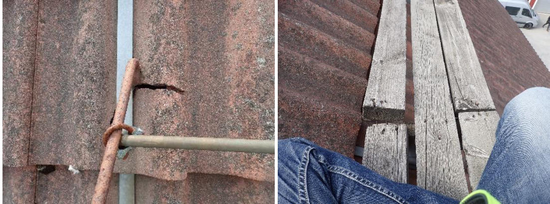
Kuvat 49 ja 50. Katolla havaittiin yksittäisiä rikkoutuneita kattotiiliä. Puiset kattosillat olivat heikkokuntoisia.
