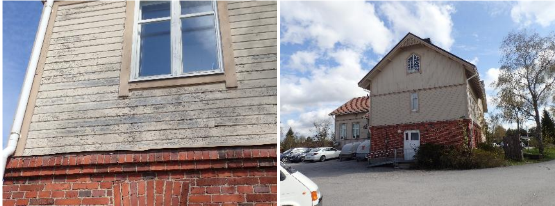
Kuvat 31 ja 32. Myös uudemman puolen ulkoverhous on paikoin heikkokuntoinen. Lounaispuolen vaakalaudoitus on uusittu lähivuosina.
