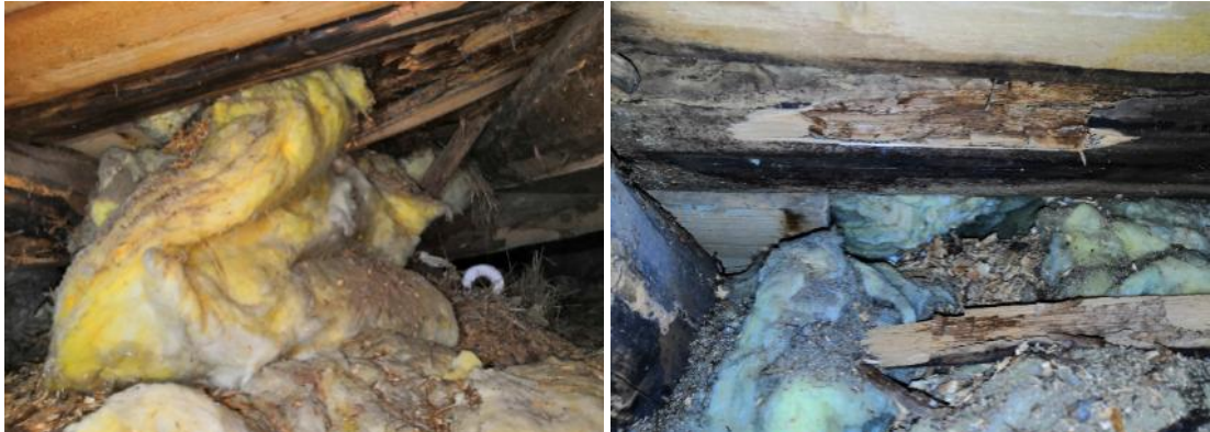
Kuvat 9 ja 10. Lahovaurioita ja romahtanutta rakennetta ryömintätilassa. Sijainti WC-tilojen 103 ja 104 alapuolella.
