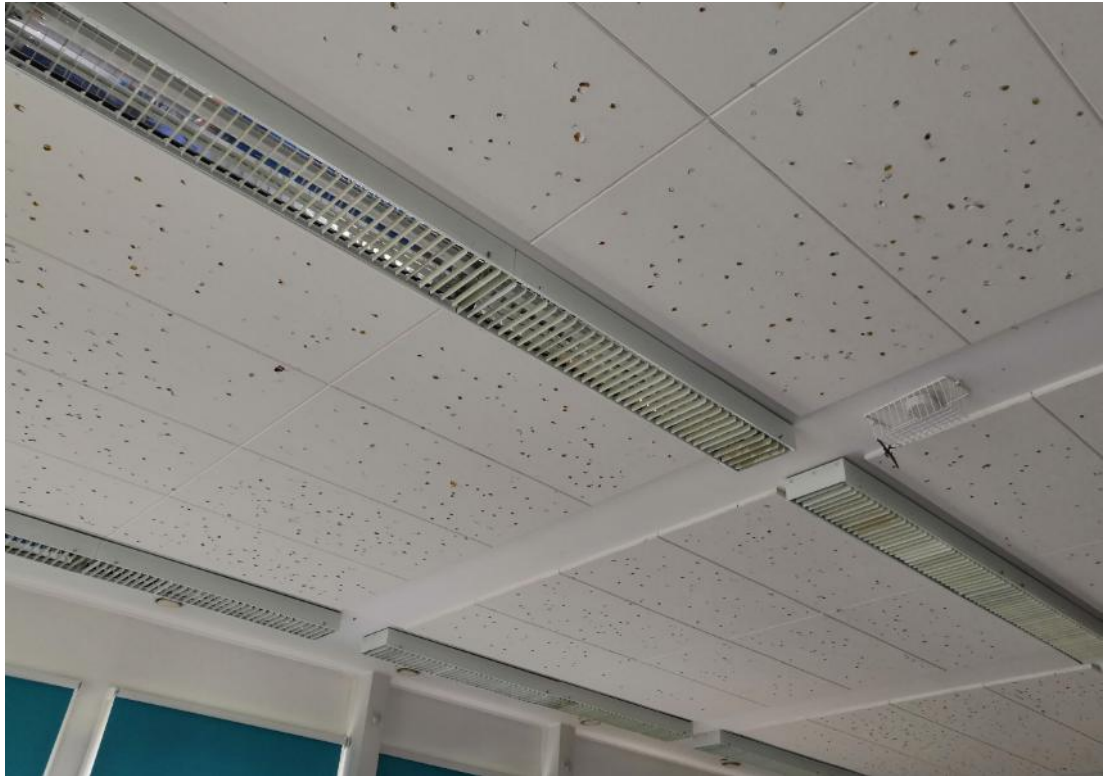
Kuva 35. Monitoimitilan katon akustiikkalevyjen pintaa on rikottu.
